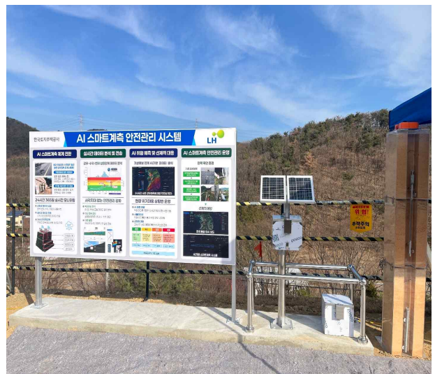
현장에 AI 스마트 계측기가 설치된 사진 (현황판 우측 태양광 시설 아래 설치됨)
